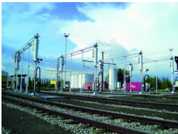
Eine im Freien installierte Besandungsanlage mit BSS2-200 (Klein Anlagenbau).
