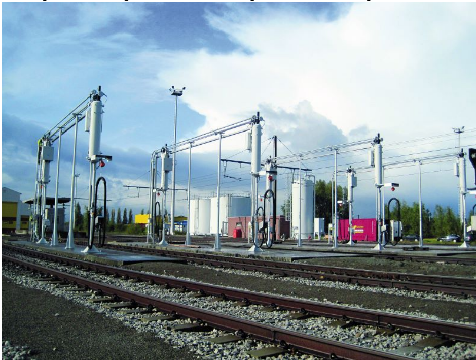
Eine im Freien installierte Besandungsanlage mit »BSS2-200« (Bild: Klein Anlagenbau).
