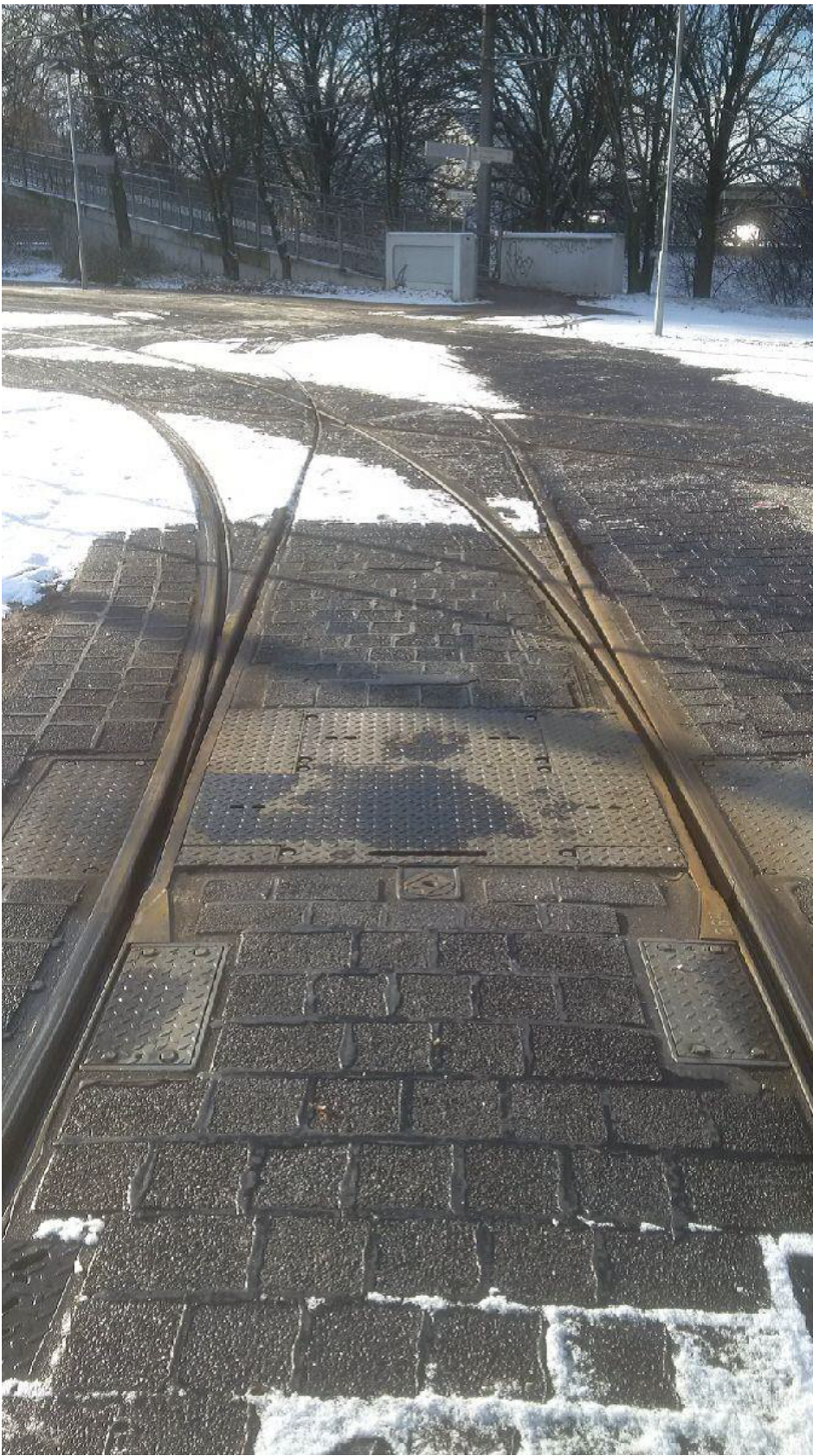
Vier Weichenheizungen werden an einer Straßenban-Wendescheife in Karlsruhe mit Restwärme aus Fernwärme versorgt und tragen damit zu einer positiven CO 2 -Bilanz bei
