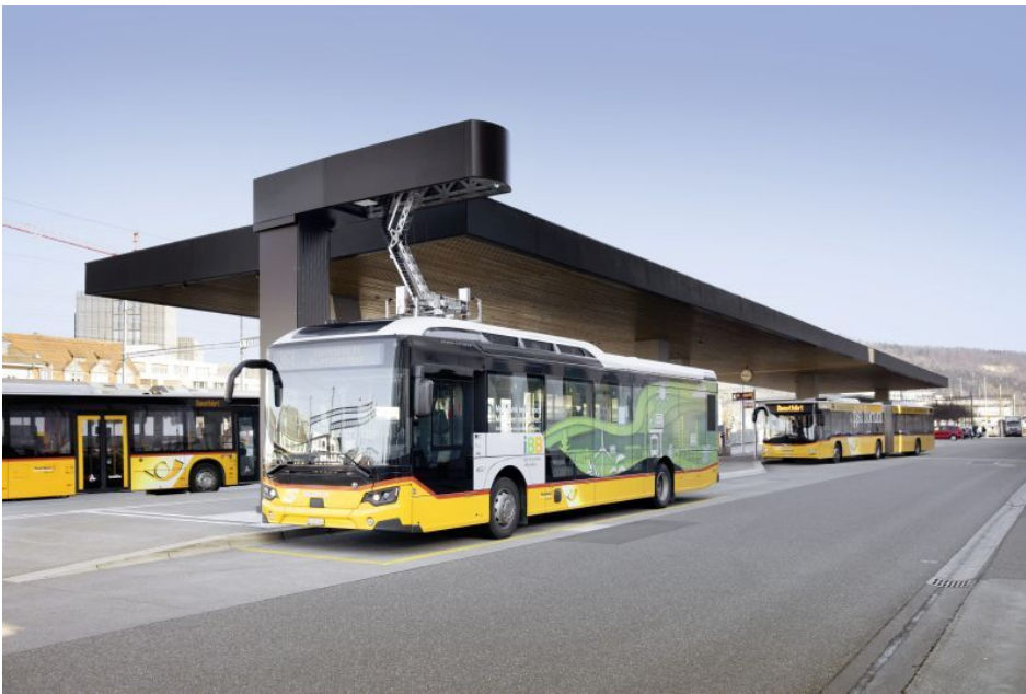
Schnellladestation »AIO« auf der Strecke in Brugg (Bild: Furrer+Frey).
