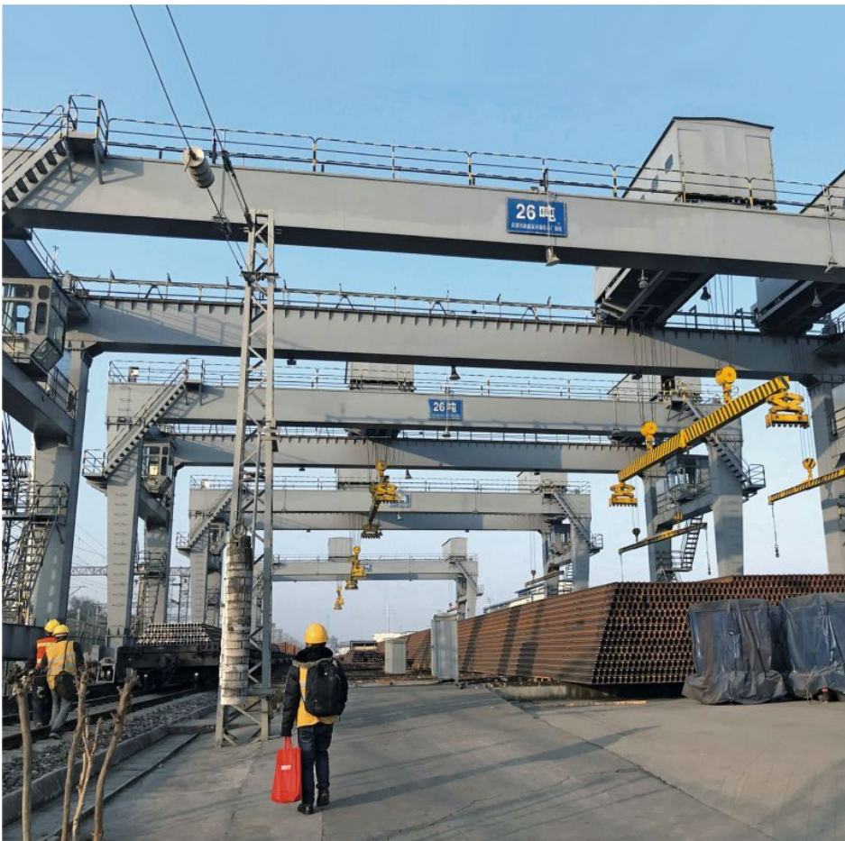
Tandemkran-Hubsystem von China Railway u. a. zur Handhabung von 100 Meter langen Eisenbahnschienen (Bild: China Railway).
