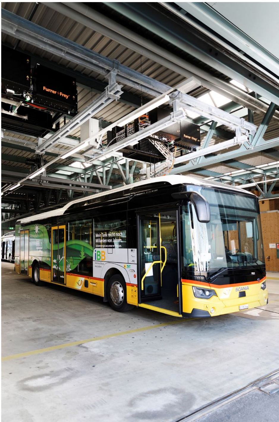
Ladestation »ZFP« für E-Busse im Depot der RVBW in Baden-Wettingen (Bild: Furrer+Freij).
