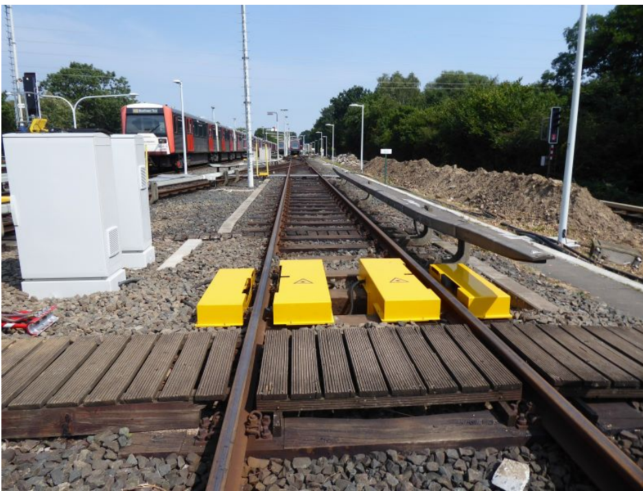
»IWMS« Outdoor-Messanlage (Bild: Hamburger Hochbahn).
